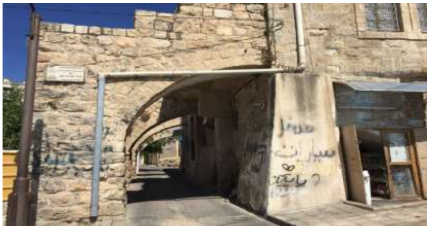
الكتابة على الجدران وانايب الصرف الصحي ادت الى حدوث تشوهات على المباني الاثرية في البلدة القديمة
